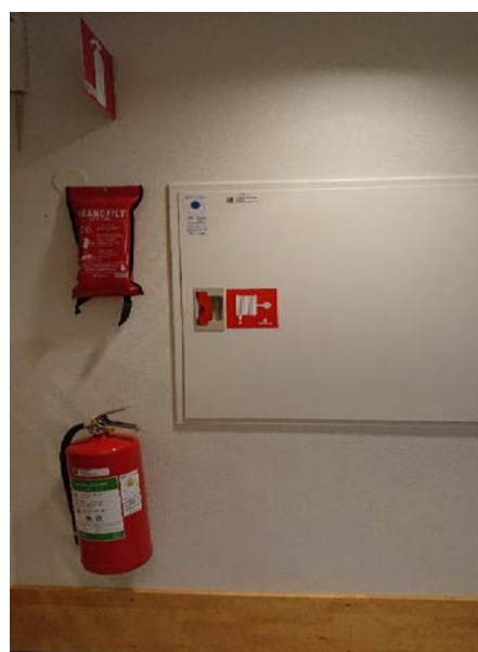
SBA fungerar. Brandredskap finns och är kontrollerade.
