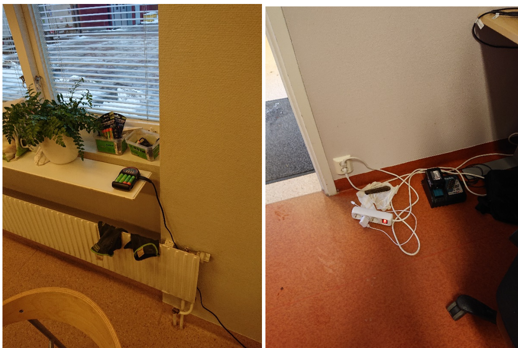
Bilder på batterier som står på laddning och skarvsladdar, skarvdosa, för laddning av utrustning. Foto VSR.
