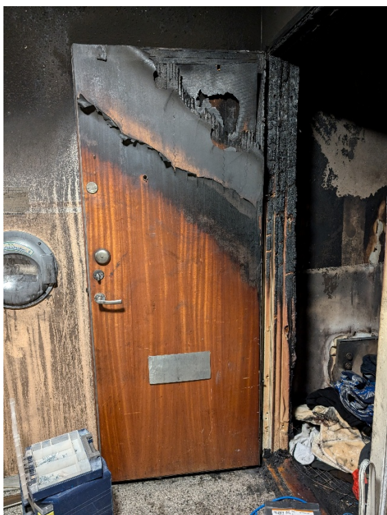
Bild på insidan av en lägenhetsdörr efter en lägenhetsbrand. Här har VSR gjort ett försök att hitta brandorsaken, men har inte kunnat fastställa den exakta brandorsaken i detta fall. Foto, VSR
