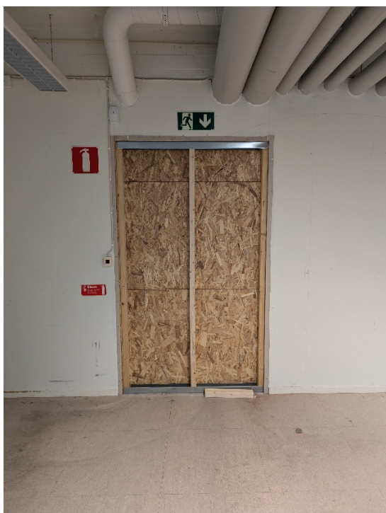
Bild på en mycket tydlig blockerad utrymningsväg som uppmärksammades vid en av VSR tillsyner 2024. Foto, VSR
